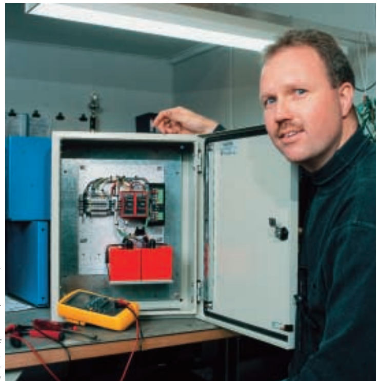
Scanpocon leverer komplette nødstrømsanlæg og komponenter til DC-backup af elektronik – både AC og DC
